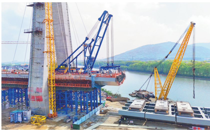
4月15日,中铁五局二公司承建的通苏嘉甬高铁控制性工程望虞河斜拉桥首根钢箱梁安装完成。该桥全长679.5米,梁体包含混合梁、混凝土梁、钢
