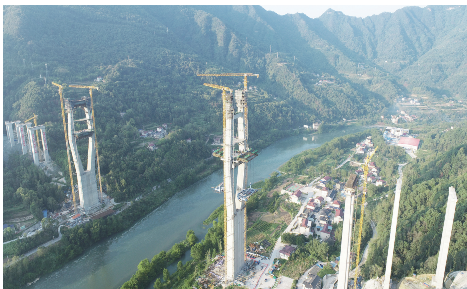
▲9月17日,中铁广州局二公司承建的沪昆高速公路长潭潭水特大桥主梁2台重达344吨的索索挂篮顺利提升到位,标志着大桥正式进入主梁悬浇段施工阶段。长潭潭水特大桥位于张家界市慈利县,大桥主塔最高为210.7米,建成后将成为“湘西第一高塔”。黄诗童 陈佳佳 杨旭辉 摄影报道
